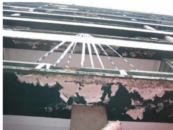
照片四：開始剝落的外牆
