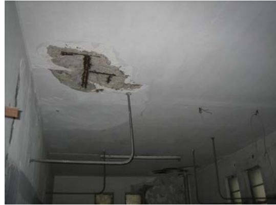
照片六：天花的上的鋼根外露
